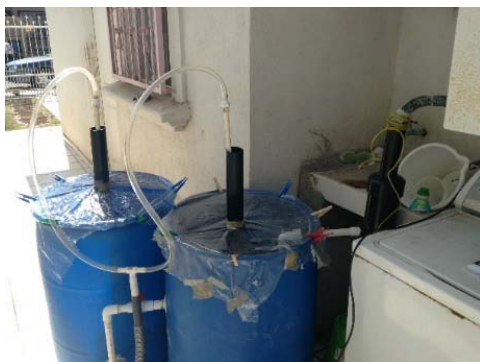
Figura 5: Sistema de tratamiento de aguas grises por aireación instalado y alimentado con agua proveniente de una lavadora.
