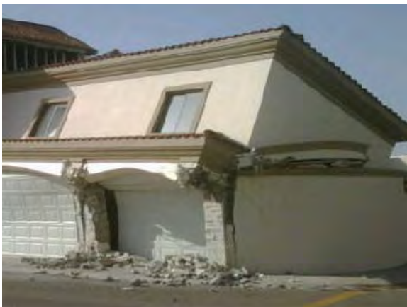
Figura 5. Edificación destruida. (Fuente: Armando R. Lara Valle (Gobierno de Baja California))
