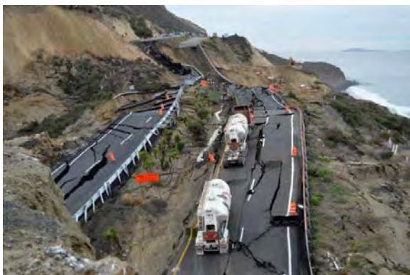
Imagen 2. Deslizamiento del talud, carretera Escénica Tijuana Ensenada, km 93 en 28-Diciembre-2013. tomada de http://eleconomista.com.mx .
