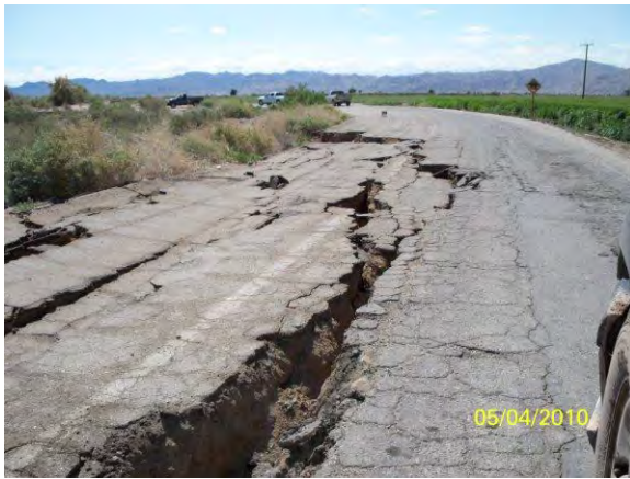
Figura 9. Agrietamientos en carretera cerca de Mexicali (Fuente: Armando R. Lara Valle (Gobierno de Baja California))
