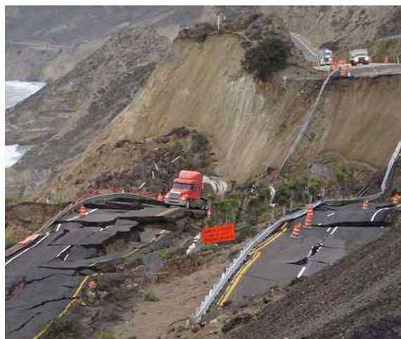
Imagen 4. Se aprecia te tamaño de las grietas y la línea de falla sobre el terreno natural.
