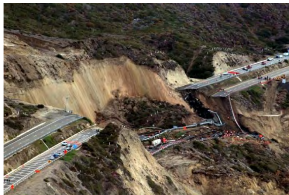
Imagen 3. Deslizamiento del talud, carretera Escénica Tijuana Ensenada, km 93, se aprecian las dimensiones aproximadas de la falla, longitud 300 metros y altura 3 m.
