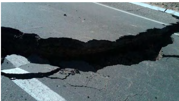
Figura 6. Agrietamientos en la carretera Mexicali - Tijuana. (Fuente: Armando R. Lara Valle (Gobierno de Baja California))
