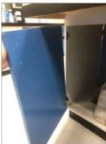
Figura 36.- Detalle del daño en mobiliario del Laboratorio de Usos Múltiples.
