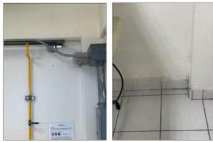
Figura 33.- Detalle de las entradas de las tuberías de agua, gas, aire y vacío (izquierda) y detalle del daño en muro con humedad (derecha) en el Laboratorio de Usos Múltiples previo a la reparación.
