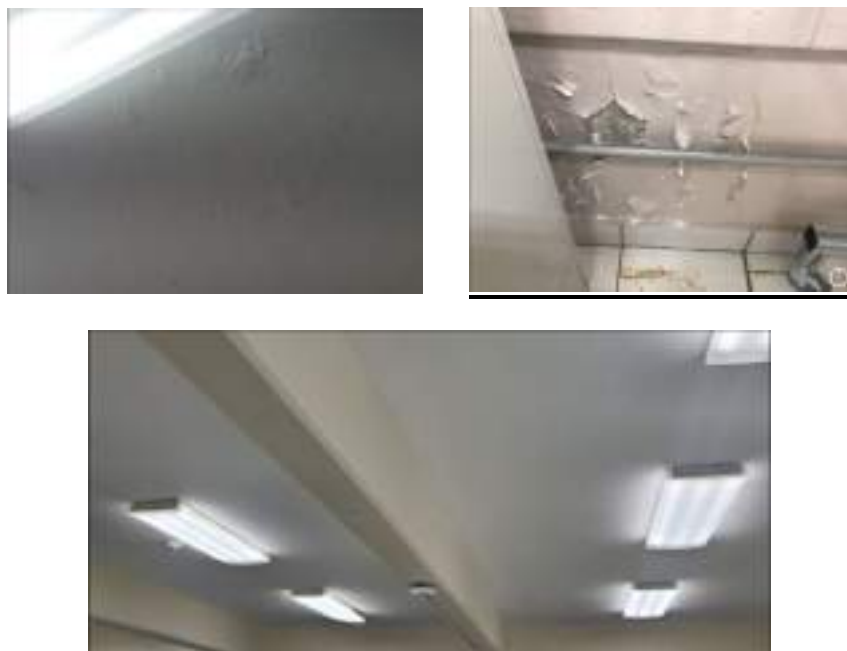
Figura 31.- En la parte superior se pueden observar detalles de los daños en techo y paredes del Laboratorio de Mediciones Físicas, mientras que en la parte inferior se muestra el techo después de las reparaciones.
