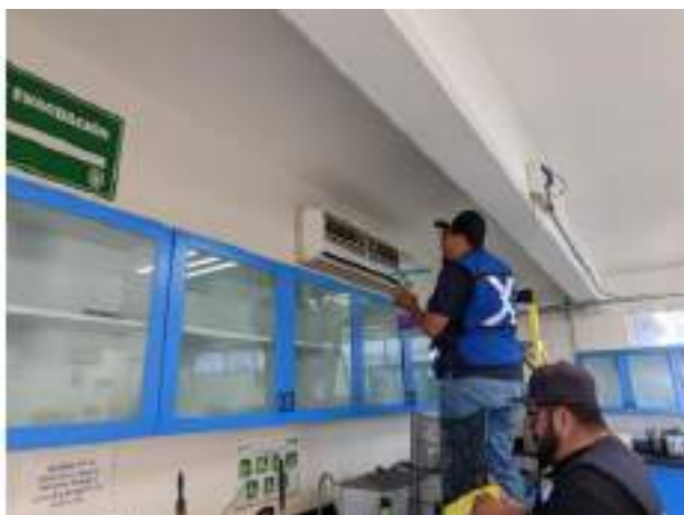
Figura 50.- Mantenimiento preventivo del aire acondicionado de los Laboratorios de Bioingeniería.
