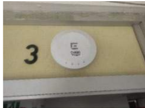
Figura 45.- Repetidor de Internet instalado en el Taller de Máquinas y Herramientas.
