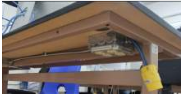
Figura 21.- Detalle de la instalación eléctrica instalada en el Laboratorio de computadoras MAC.
