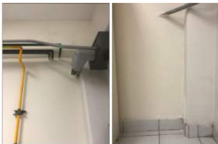
Figura 34. Detalle de las entradas de las tuberías de agua, gas, aire y vacío (izquierda) y detalle del daño en muro con humedad (derecha) en el Laboratorio de Usos Múltiples posterior a la reparación.
