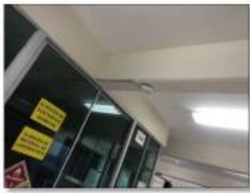
Figura 32.- Detalle de la instalación del modem al interior del Laboratorio de Usos Múltiples.
