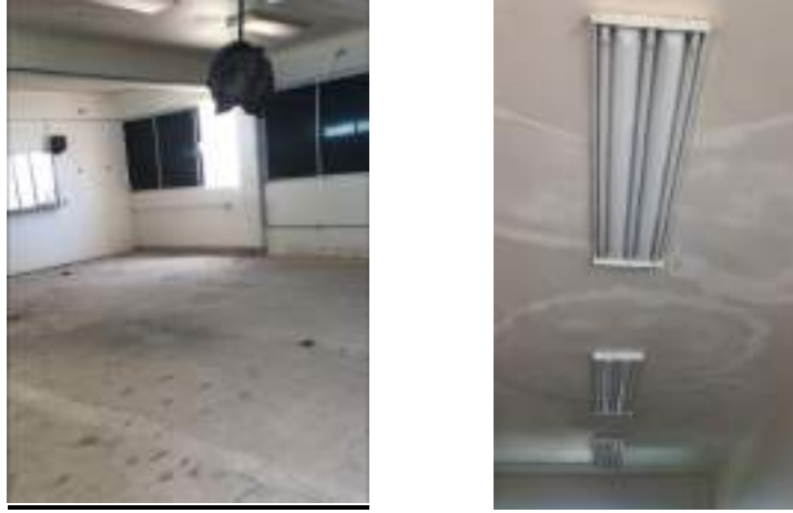
Figura 28.- Estado de techo y piso previo al mantenimiento y reparación.
