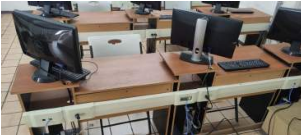
Figura 18.- Detalle de la instalación del Rack y cableado de terminales en el Laboratorio de Cómputo.
