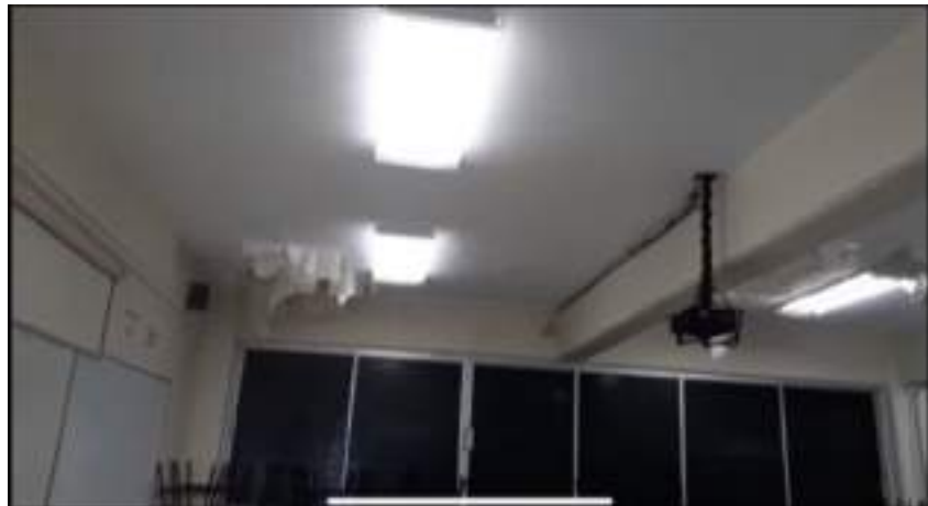
Figura 30.- Daños en el techo del Laboratorio de Mediciones Físicas debidas a filtraciones de agua.
