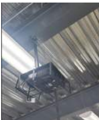
Figura 20.- Proyector de aulas en edificio E55.
