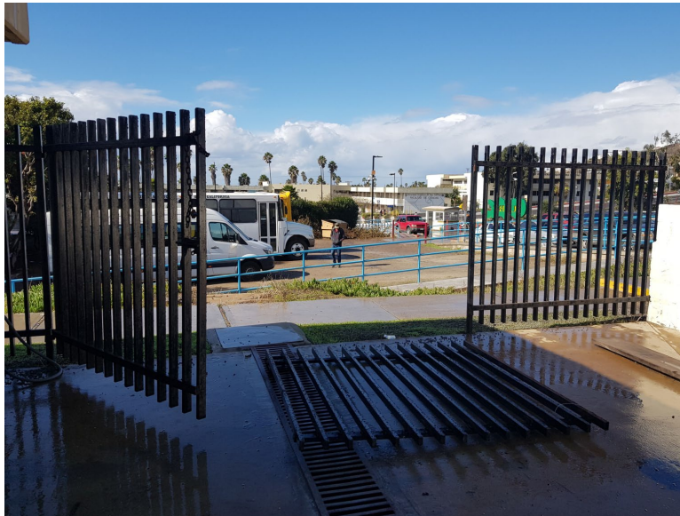
A 13.- Imagen de la reja de acceso (dañada) al Laboratorio de materiales, geotecnia y topografía.
