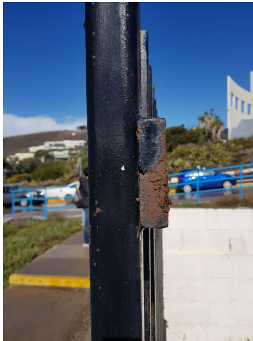
A 14.- Detalle del daño en la reja de acceso al Laboratorio de materiales, geotecnia y topografía.
