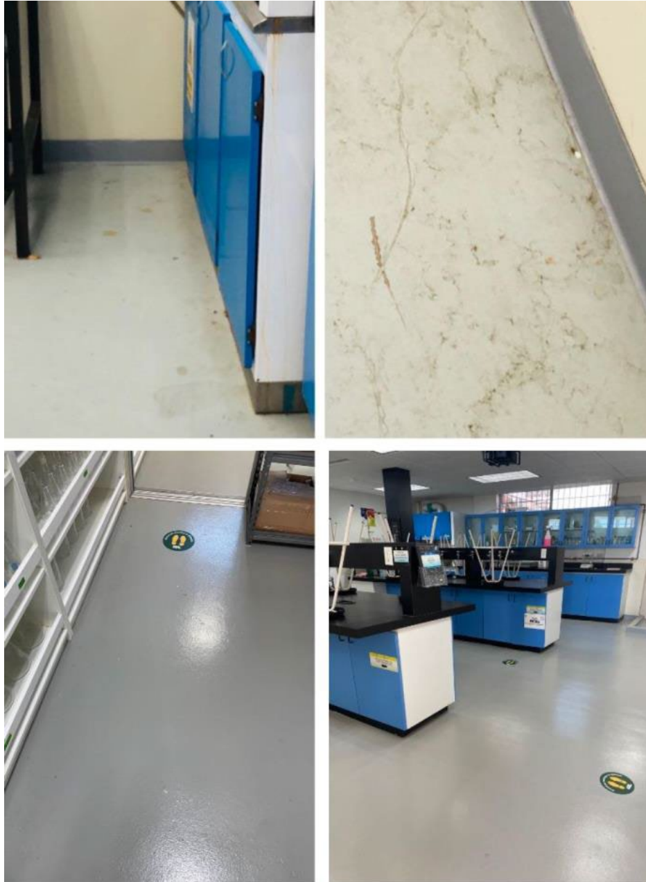
A 44.- Pintura de los pisos de laboratorios y almacén, antes (a y b) y después (c y d).
