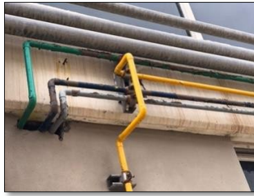
A 28.- Líneas externas del laboratorio (antes del mantenimiento).
