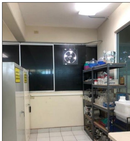
A 35.- Extractor instalado dentro del almacén del laboratorio de Química.
