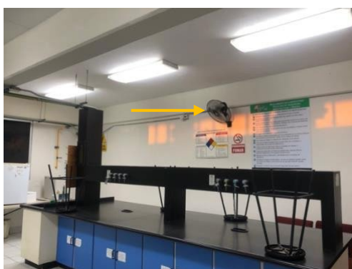
A 38.- Ventilador en el ala 2 del laboratorio de Química.
