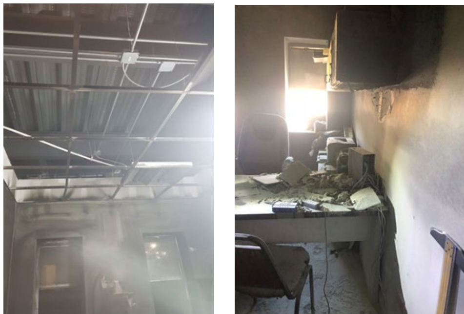
Figura A 36. – Daño por incendio del cubículo del Dr. Francisco Fernández Melchor.
