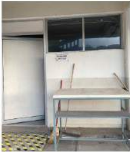
Ilustración 25. Ventana sin protección (Antes)
