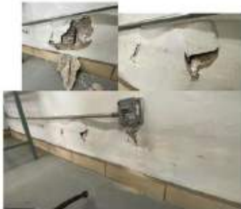
Ilustración 16. Paredes dañadas (Antes)
