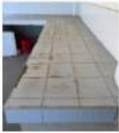
Ilustración 20. Barra de trabajo con daño (Antes)
