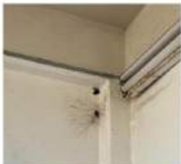
Ilustración 12. Huecos en paredes del patio (Antes)
