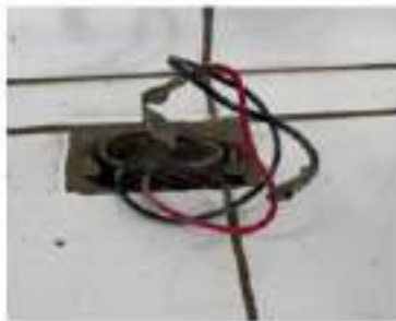
Ilustración 22. Falta de tomacorrientes (Antes)
