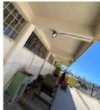
Ilustración 15. Reflectores del patio trasero (Después)
