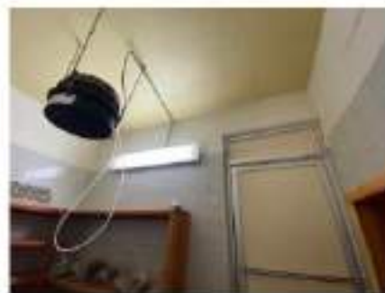
Ilustración 19. Cuarto de curado (Después)
